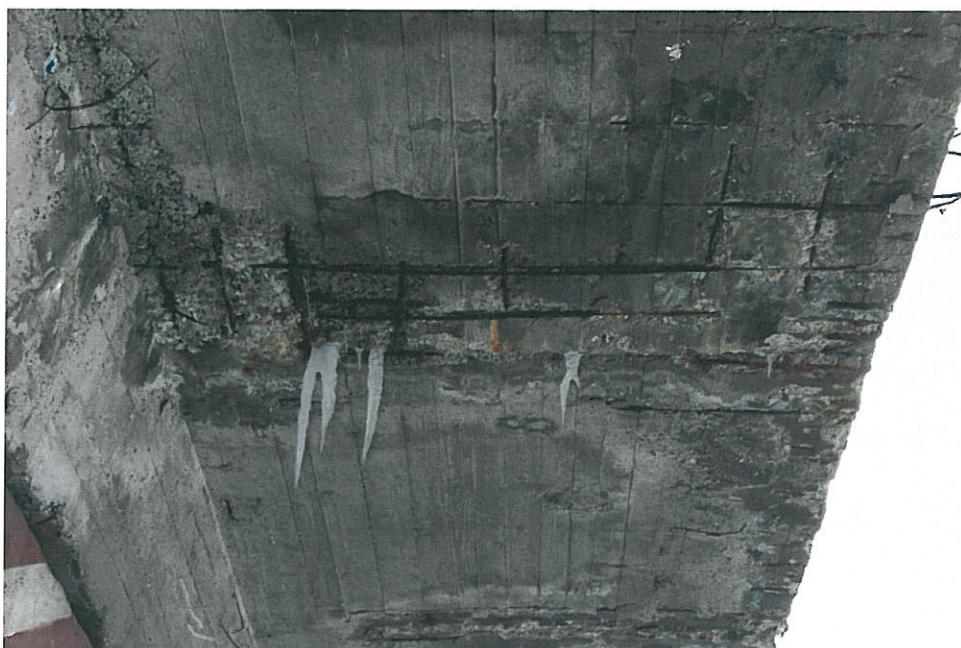
FOTO 6 – Detaliu consola intrados la rostul pilei
